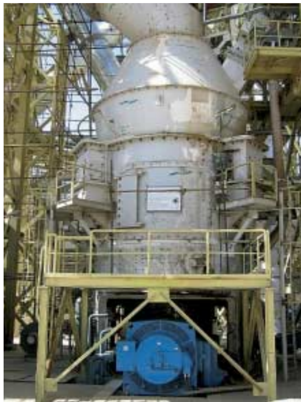
1 Rohmühle MPS 3350 B im Werk Kavir Kashan Cement Co., fertig zur Inbetriebnahme 1 Raw mill MPS 3350 B at Kavir Kashan Cement Co. ready for commissioning
