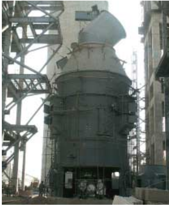
3 Rohmühle MPS 5000 B kurz vor Abschluss der Montage im Werk Tehran Cement 3 Raw mill MPS 5000 B shortly before the completion of erection at the Tehran Cement works
