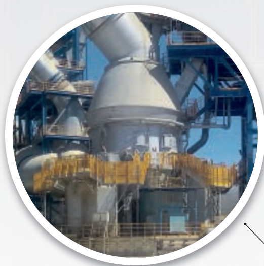
Moagem de cru de cimento com os moinhos verticais de rolos MVR
