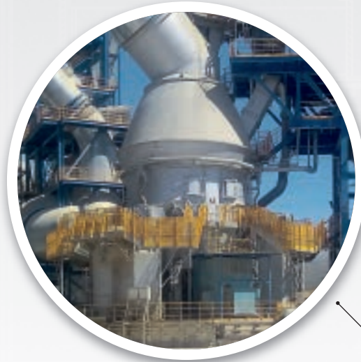
Molienda de crudo de cemento con molinos verticales de rodillos MVR
