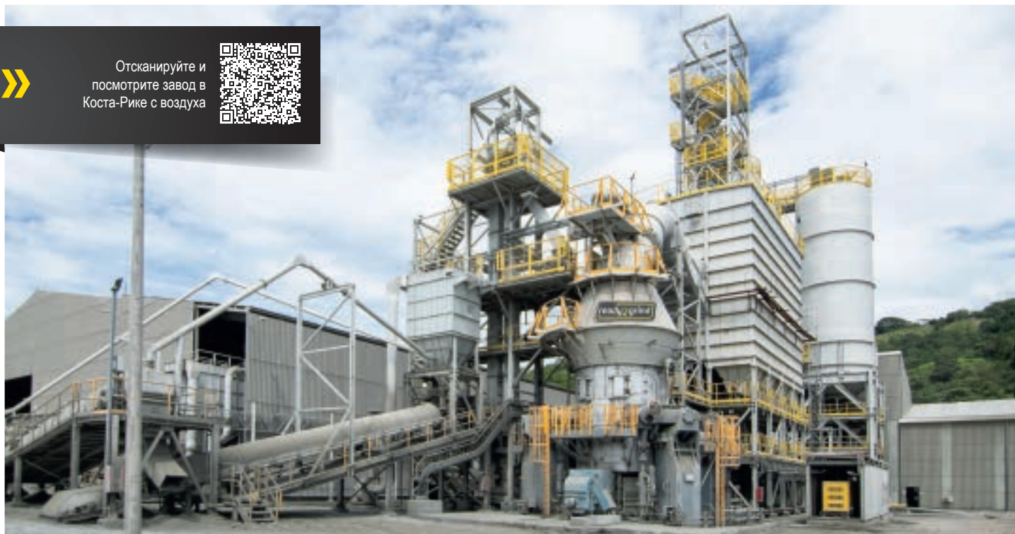
R2G 2500 C-4: Сердце установки ready2grind в Коста-Рике, как всегда, мельница MVR с 4 помольными валками
