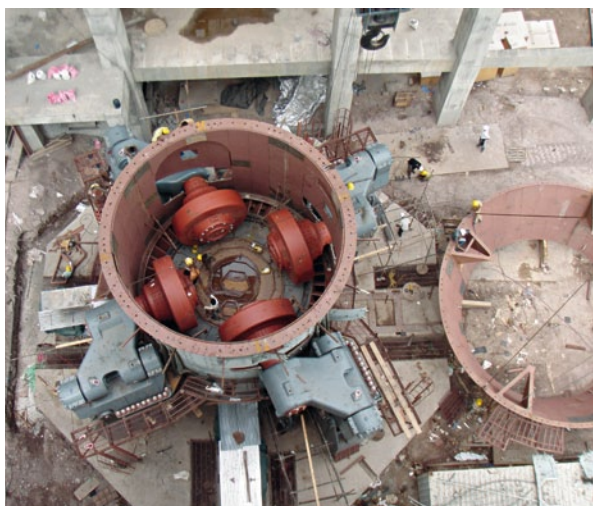
8 Installed roller modules (Balaji, India) Montierte Walzenmodule (Balaji, Indien)
