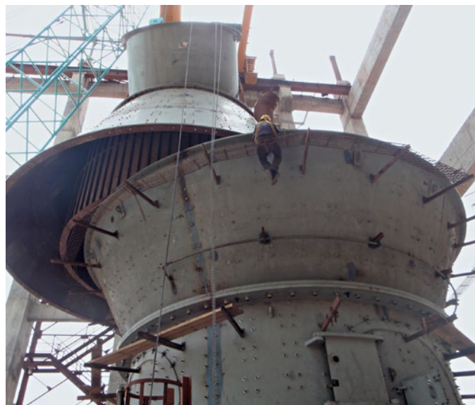
9 Erection of the classifier top part (Balaji, India) Montage des Sichteroberteils (Balaji, Indien)
