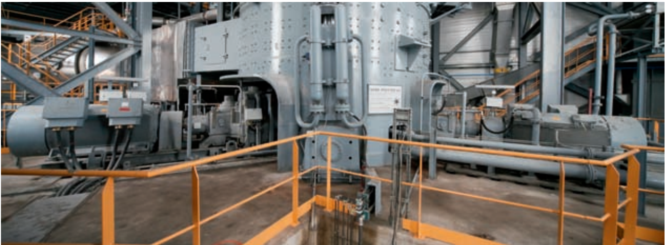
MultiDrive® with 1450 kW modules for Holcim in France • MultiDrive® mit 1450-kW-Modulen für Holcim in Frankreich
